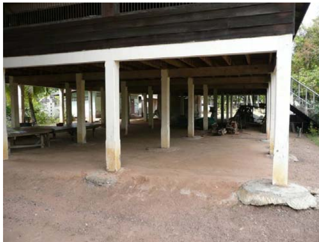
ภาพประกอบ 6 แสดงการยกอาคารให้สูงขึ้น โดยทำเสาคอนกรีตมารับอาคาร
