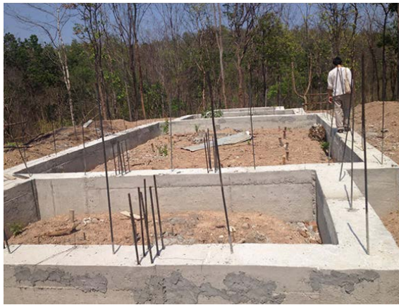
ภาพที่ 5 ฐานราก คสล. สำหรับรับน้ำหนักโครงสร้าง
